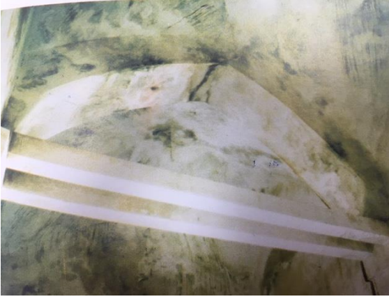
Resim 5. 2001 Restorasyonu öncesi giriş bölümü iç görünüş Restorasyonu öncesi kemer iç görünüş (Acun, 1999)
