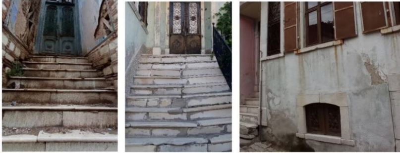
Şekil 18. Kula'da bulunan Rum Evi cephe elemanları bozulma örnekleri. Solda ve ortada Rum Evi giriş bölümü merdiven bozulması, sağda Rum Evi cephe yüzeyi bozulması (Eymen Tatlıhalat Arşivi-2022)
