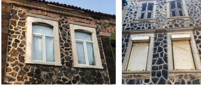
Şekil 17. Kula'da bulunan Rum Evi cephe elemanları bozulma örnekleri. Solda Rum Evi pencere doğraması malzeme değişimi, sağda Rum Evi kepenk malzeme değişimi (Eymen Tatlıhalat Arşivi-2022)
