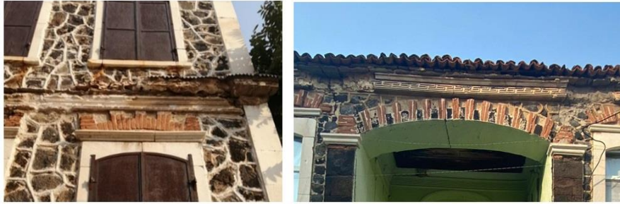
Şekil 15. Kula'da bulunan Rum Evi cephe elemanları bozulma örnekleri. Solda Rum Evi kat silmesi bozulması, sağda Rum Evi saçak alt bölümü bozulması (Eymen Tatlıhalat Arşivi-2022)
