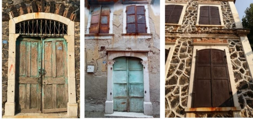
Şekil 16. Kula'da bulunan Rum Evi cephe elemanları bozulma örnekleri.
